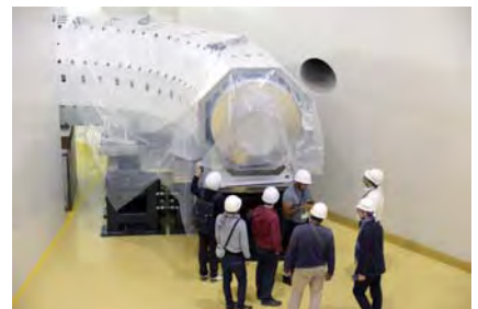
設置されたソレノイド電磁石 (HD/南実験棟地下1階)
