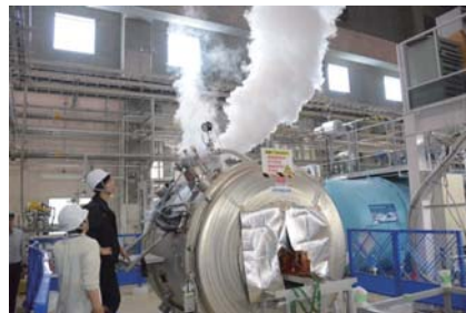
超伝導MRI電磁石のクエンチ試験 (ニュートリノ第1設備棟)
