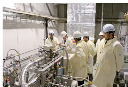
ガス循環検出器設備の確認
