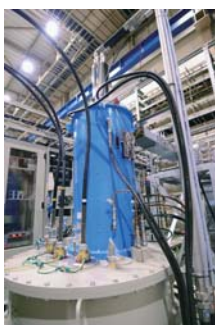
400MeV運転のための高周波源(クワイトロ) (リニアック)
