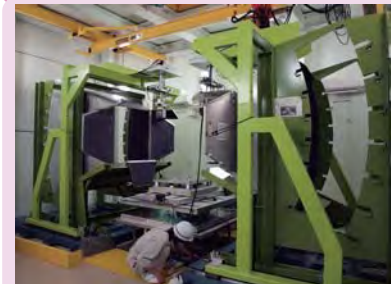
MLF 西側実験棟の沈下を復旧するため、実験装置等を一時撤去。写真は検出器等が取り外された BL19「匠」。
