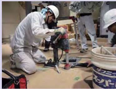
リニアック建屋周辺の地盤沈下、床下に一部空隙が生じ、調査のため床への穴明け作業を実施。
