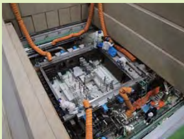
ニュートリノターゲットステーションでは、大型ヘリウム容器を開き電磁ホーンの点検を実施。
