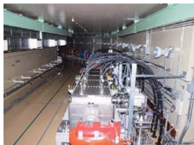
3GeVシンクロトロントンネル内の加速器装置、目視確認では重篤な破損は見受けられず。（3/23）ビームダクトの真空度検査中。
