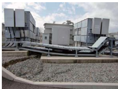
3GeVシンクロトロンの屋外電源設備ヤード。沈下により受電設備やコンデンサなどが傾斜。
