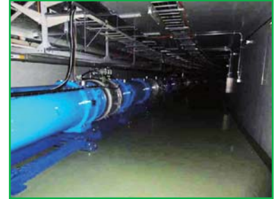
ニュートリノ陽子ビーム輸送ラインの超伝導電磁石。トンネル内に目立った漏水は無し。
