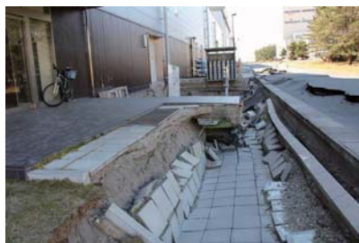
リニアック玄関前。建屋周囲の広い範囲で約1.5mの陥没。配線や配管の一部が破断。
