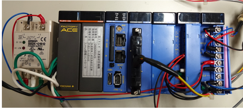
図. 1.2: PLC システムの外観. DAC/ADC/高速入出力モジュールと Linux が動作する CPU などから構成されている。
